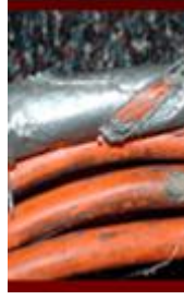
Şekil 22 Yıpranmış elektrik ekipmanları değiştirilmelidir.
